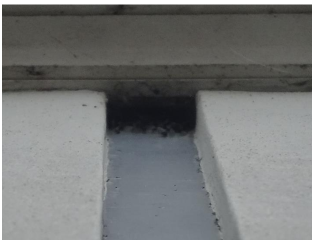
Foto 11: dichte ondiepe holte.
