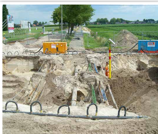
Kabels en leidingen
